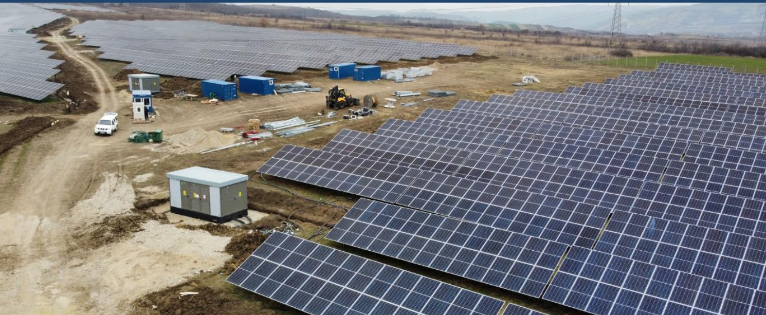
Parcul solar CEF Izvoru Barzii de 14,8 MWp și 14,175 MW, județul Mehedinți, România, administrat de Premier Energy
